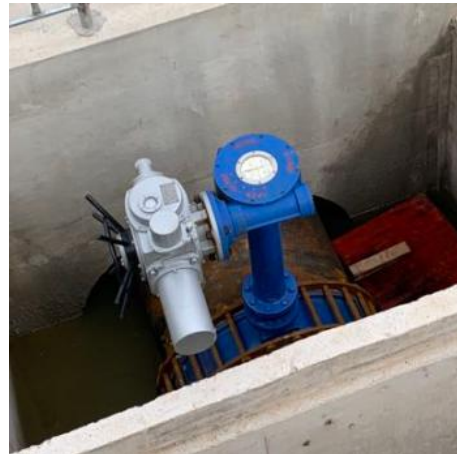
应急事故池闸阀
