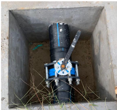
罐区事故管网闸阀
